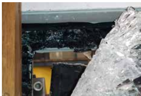
Immagine 1: Delaminazione dell'angolo del vetro su serramento in PVC.
